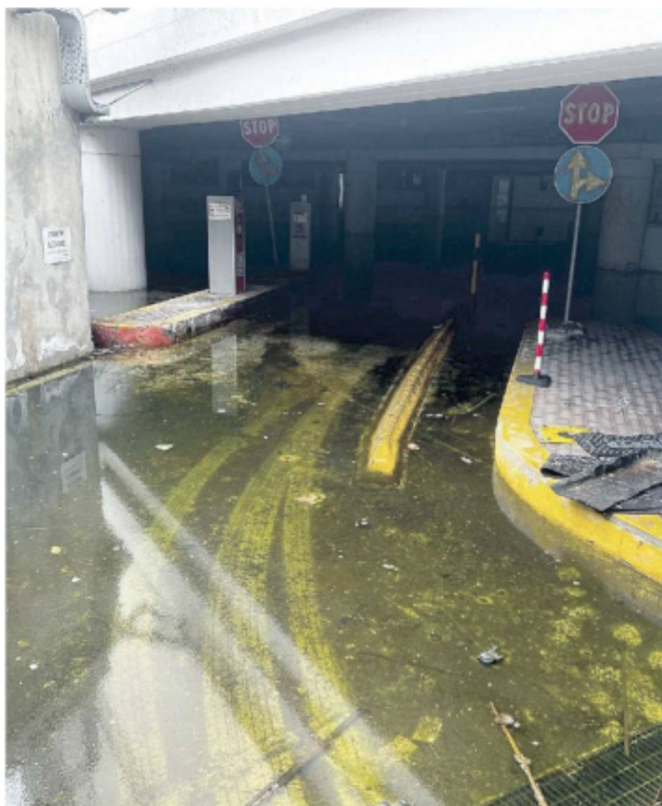
DEGRADO L'accesso al parcheggio sotterraneo del centro commerciale Le Torri: una palude
